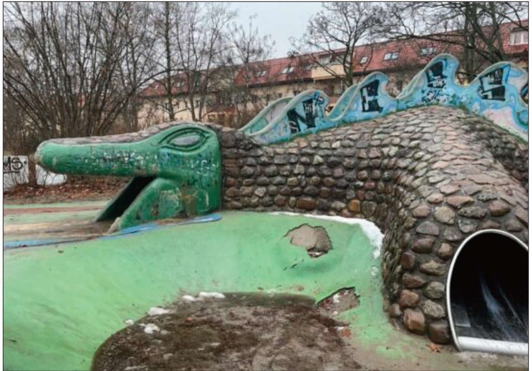
Überall Kritzeleien, bröckelnder Putz: Das Spielplatzmonster Nessie hat schon bessere Zeiten gesehen.
